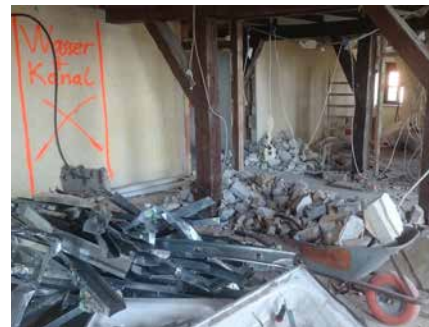
So sah das Dachgeschoss der Burg Wernfels kürzlich noch aus. Infos zum Baufortschritt: S. 25
